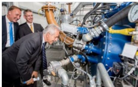
Ministerpräsident Stanislaw Tillich (vorn) besichtigt im Beisein von Volker Schulz, Vorstandssprecher und Michael Fitzke, Prokurist GETEC heat & power AG das neue Industriekraftwerk
