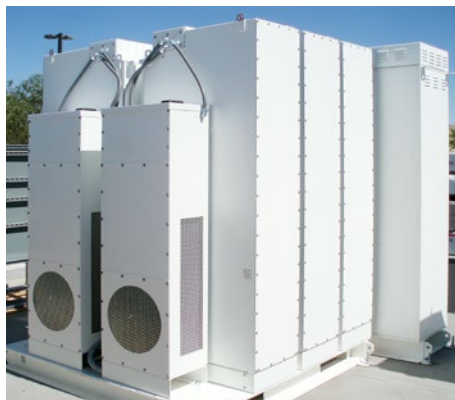
Mit Batteriespeichern lassen sich Stromkapazitäten effizient nutzen.
