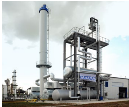
Die neue Thermalölanlage bei Haltermann nutzt ein in der Produktion anfallendes Ventgas zur Energiegewinnung.
