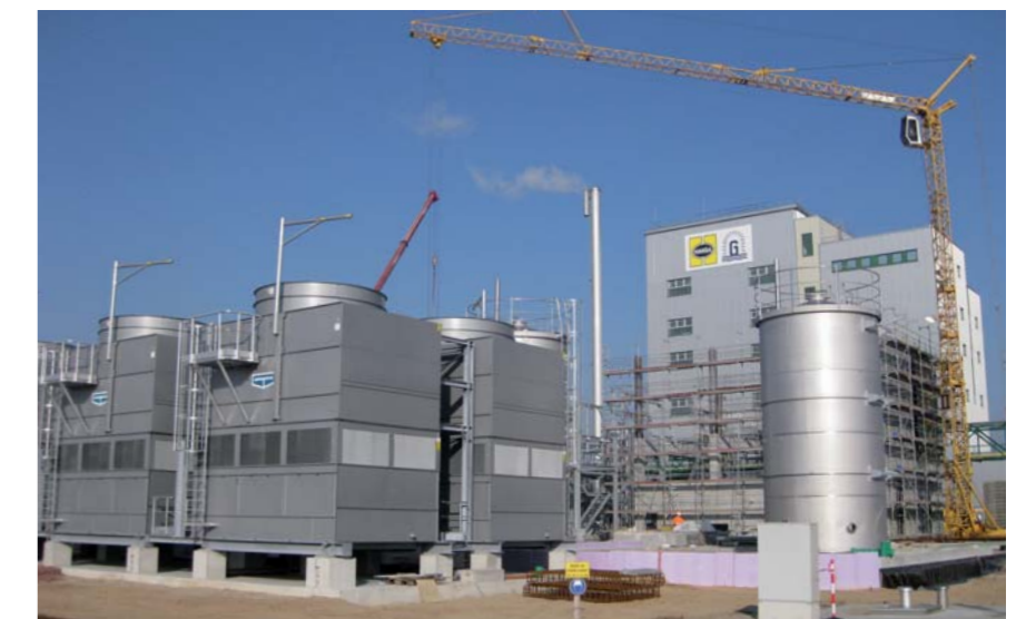
Die neue Tensidanlage im Waschmittelwerk Genthin wird künftig von GETEC versorgt.
