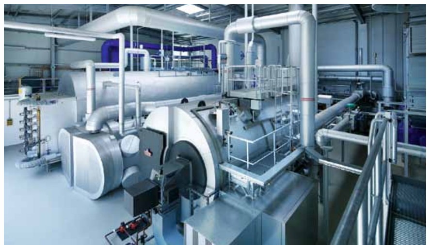
Auch in der Papierfabrik Hainsberg sichert GETEC die Dampfvorsorgung mit einer BKS-Anlage.
