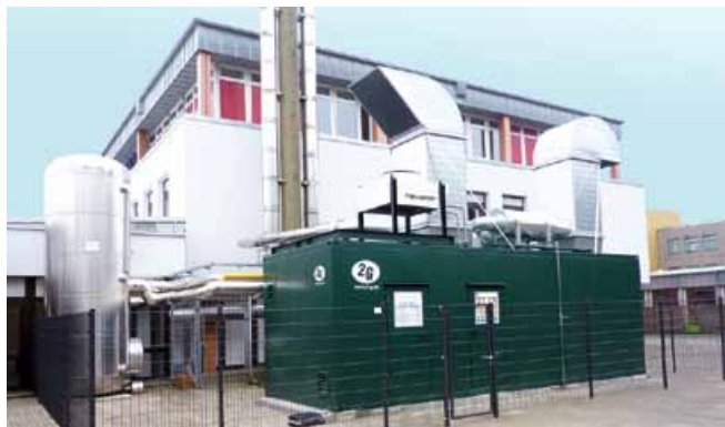
Grüngas-BHKW für das Schulzentrum II in Buchholz
